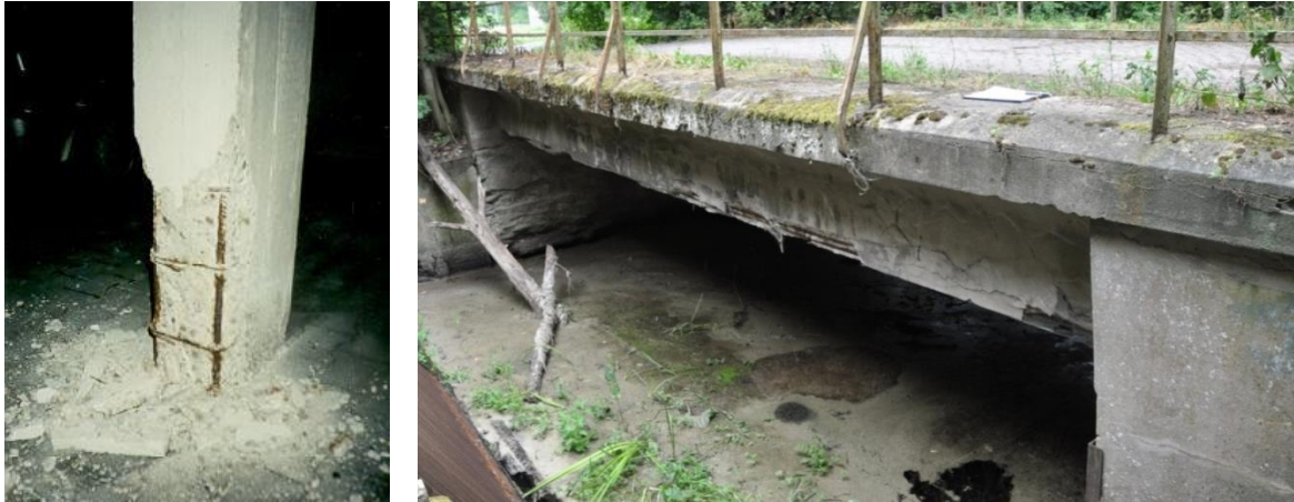
Abb. 1. und 2. Typische Schadensbilder an Stahlbetonkonstruktionen
