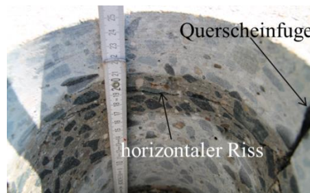
Abb. 5. Innenwand eines Bohrlochs an Fuge mit horizontaler Rissbildung ausgehend vom Kerbschnittgrund. Vor der Bohrung durchgeführte Messung an dieser Fuge s. Abb. 4, links.
